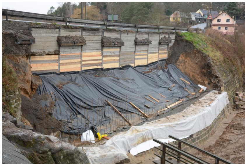
Obr. 26. Pohled na zčásti obnažené těleso hráze Novozámeckého rybníka při opravě v listopadu 2015. Oproti údajům v literatuře není hráz sypaná (alespoň v tomto úseku), ale její jádro je tvořené pískovcem. Pohled k S. Foto J. Adamovič.
