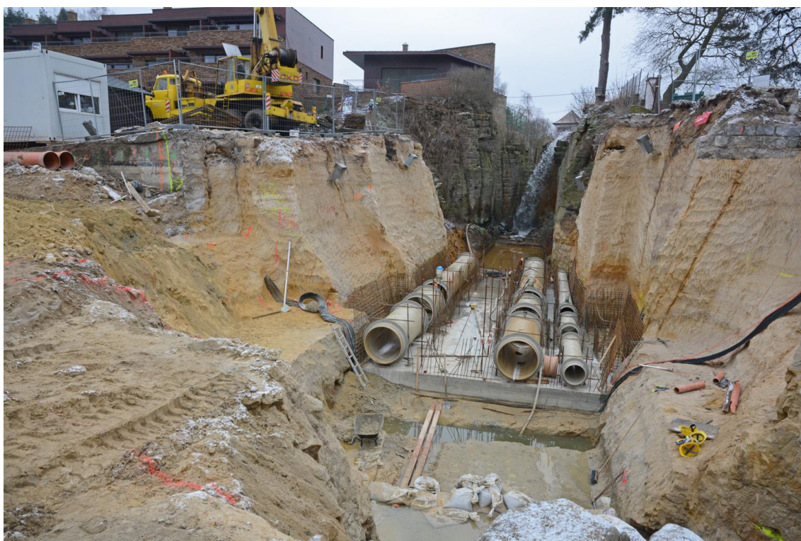
Obr. 6. Staveniště při rekonstrukci výpustního zařízení ze dne 24. 1. 2015, pohled z provizorní bariéry do odtokové strouhy (po proudu Robečského potoka). Foto J. Adamovič.
